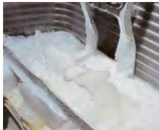
Eisbildung am Außengerät ohne Wannenheizung
