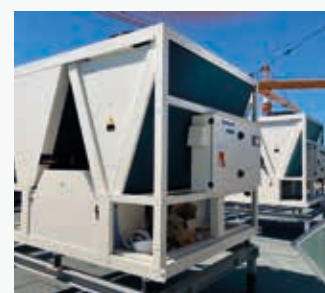
Cédrus Liget. Gebäudekomplex mit Apartments, Büros, Geschäften usw. Szeged, Ungarn. ECOi-W, ECOi + Lüftungseinheiten mit Wärme- und Feuchterückgewinnung
