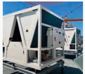
Cédrus Liget. Gebäudekomplex mit Apartments, Büros, Geschäften usw. Szeged, Ungarn. ECOi-W, ECOi + Lüftungseinheiten mit Wärme- und Feuchterückgewinnung
