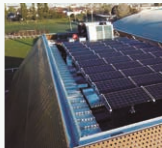
Complexe Sportif des Amandiers. Sportkomplex. Carrières-sur-Seine, Frankreich. ECOi-W
