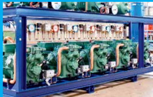
R134a /R744 Kaskadenanlage für Wurstwaren Portionierung
