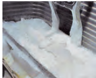
Eisbildung am Außengerät ohne Wannenheizung
