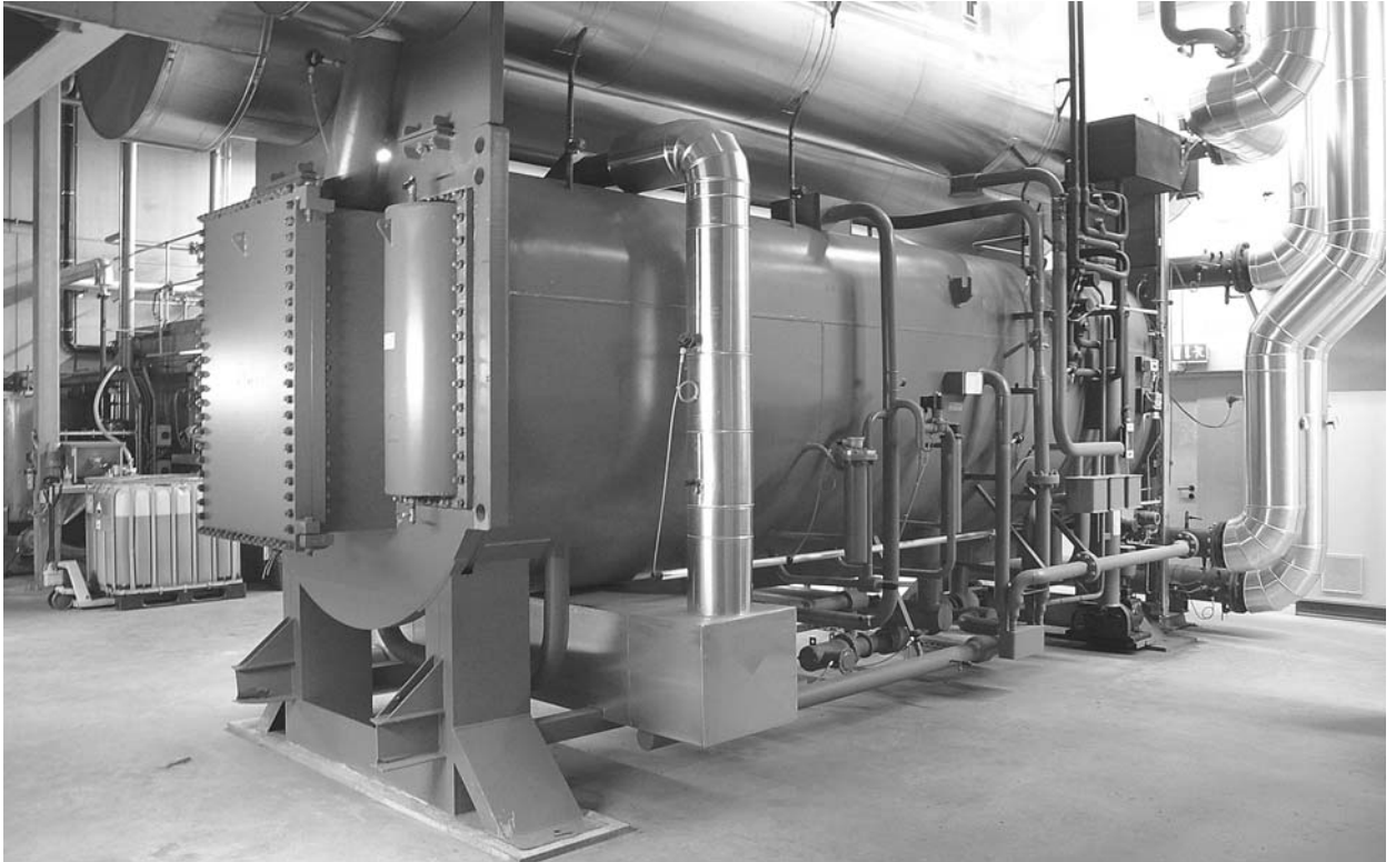
Bild 18: Lithiumbromid-Absorptionswärmepumpe mit einer Kälteleistung von 14000kW
